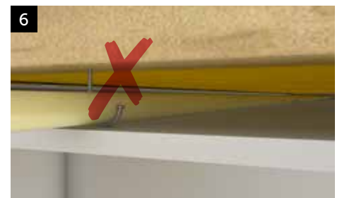
6 Kontakt mellan upphängning för t.ex. VP-rör och gipsskiva ger kraftigt försämrad ljudisolering.
