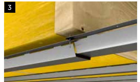
3 Skarvning sker över stöd med profilerna kant i kant och de båda förborrade hålen rakt över varandra.
